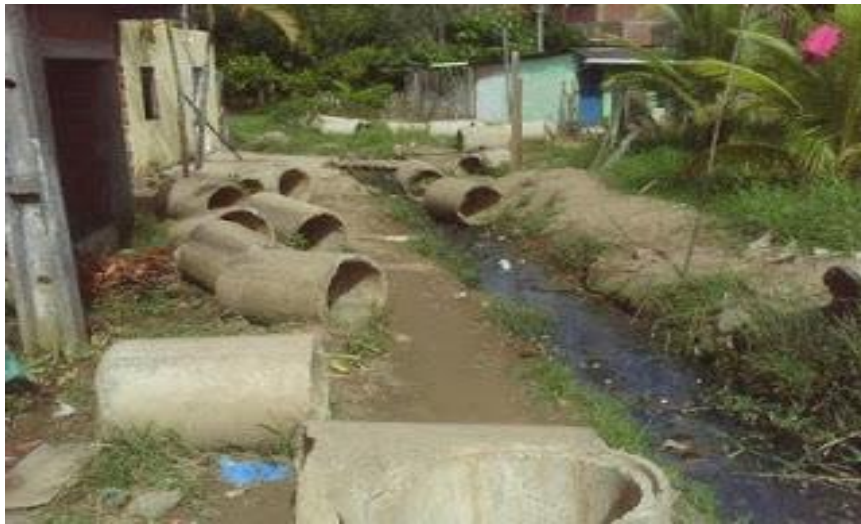
Comunidade Guabiraba - Itambé-PE /Monitora: Gilda Maria Tema Gerador: Ruas esburacadas
